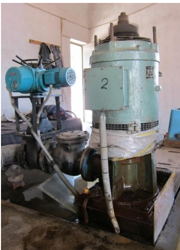
Abb. 1: Motor, Ventil und Druckleitung einer besichtigten Pumpenanlage
